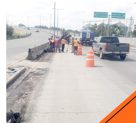
En el paso a desnivel se ha tapado por la basura.
