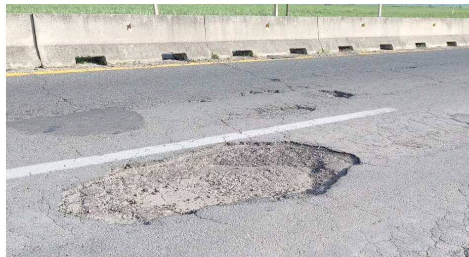
Reportan los alcalde que la carretera Federal 70 presenta un deterioro crítico.
